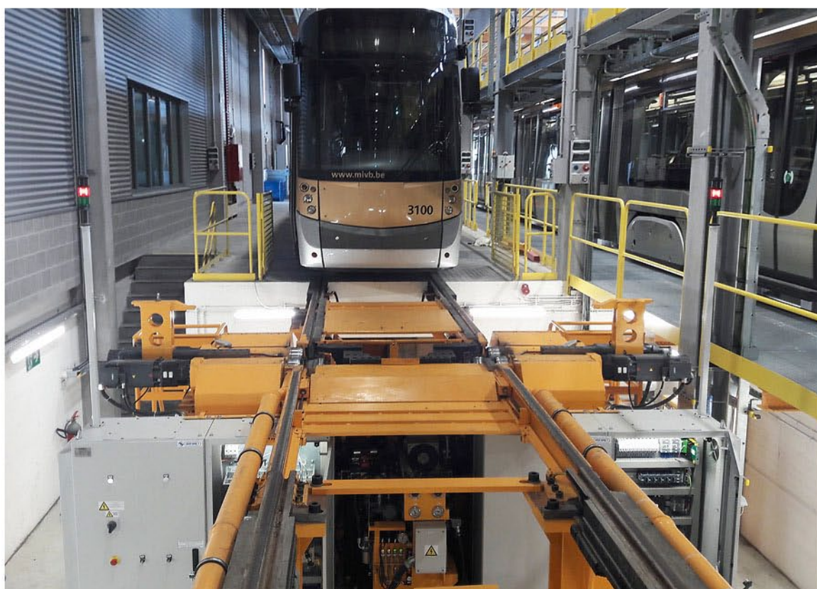
Rys. 1. Tokarka UGE 180 N zainstalowana w fundamencie poniżej poziomu torów.
